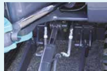
Mangueras de la niveladora articuladas.
